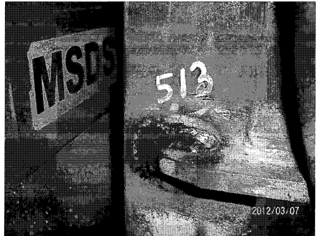
Photo 5: Indication abolie et rectifiée sur la partie inférieure gauche de la composante reliant nacelle et flèche.
