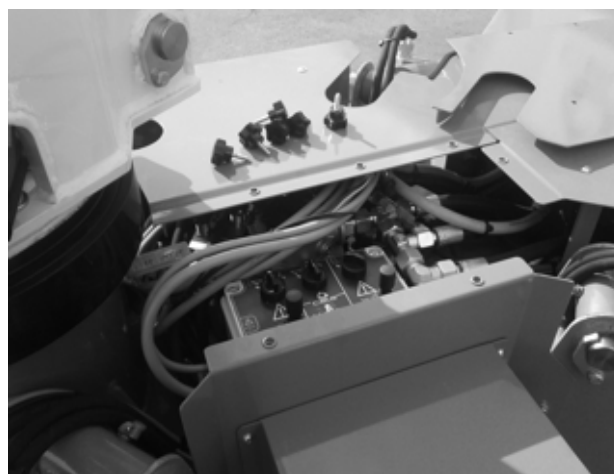
Pannello accesso emergenza aperto
