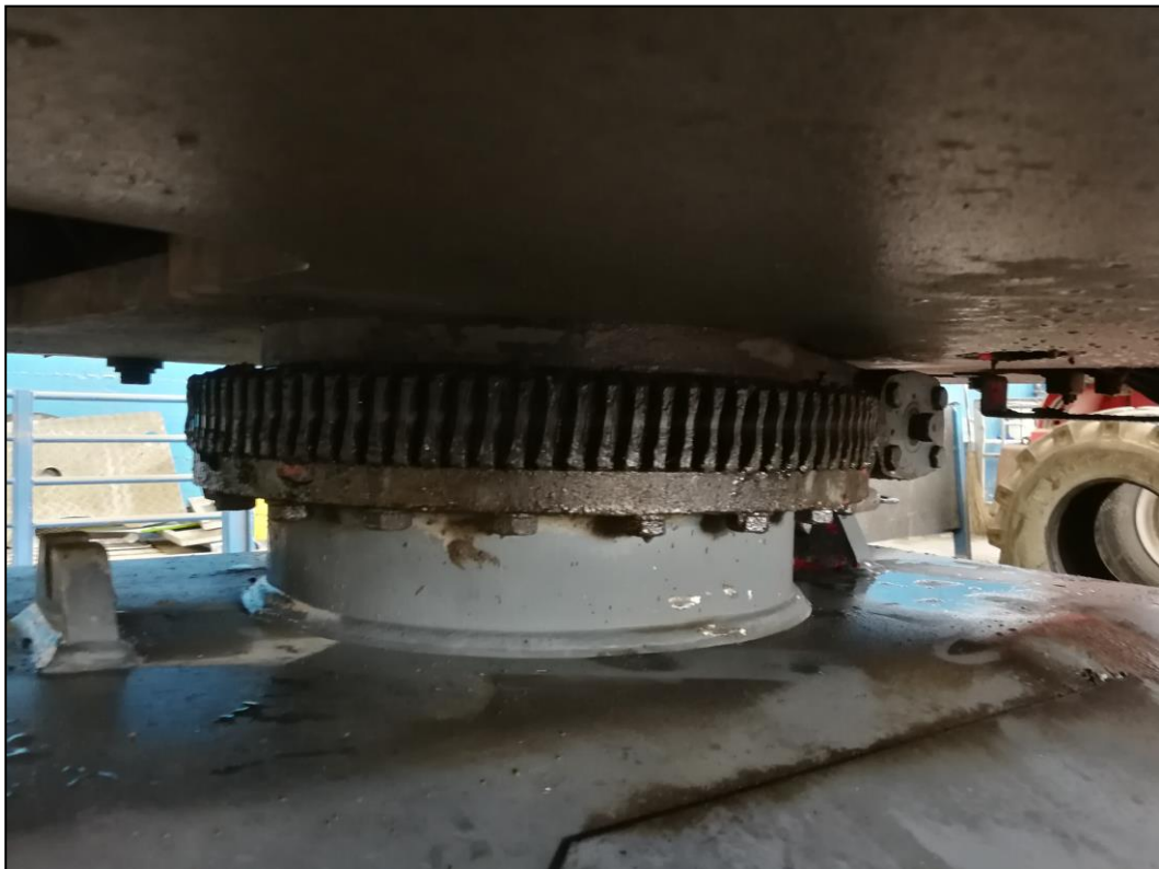
Figura 5 - Stato di conservazione della ralla di rotazione
