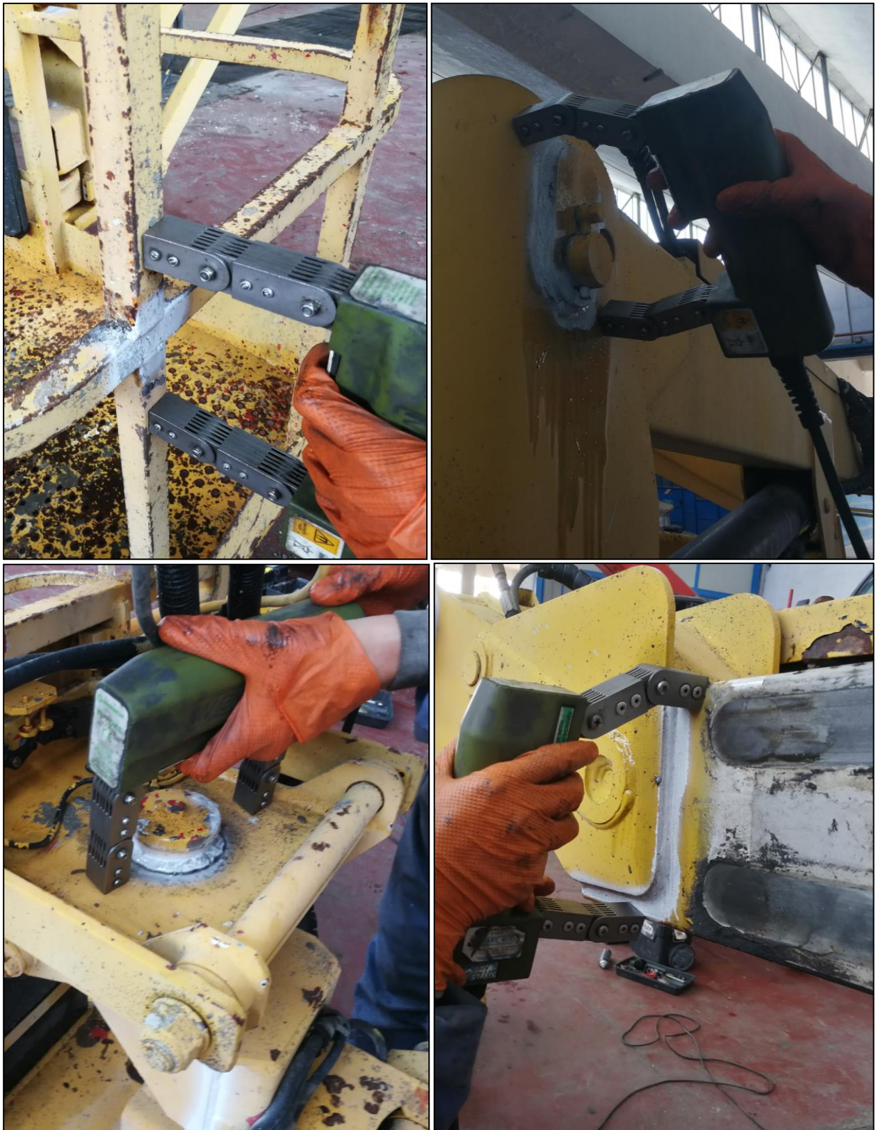
Figure 8 / 9 / 10 / 11 - Prove magnetoscopiche eseguite sulle saldature
